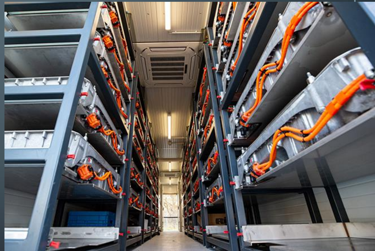
Armazenamento estacionário para apoiar o carregamento de autocarros elétricos, (VW e MAN Truck & Bus ) Bergedorf quarter of Hamburg
